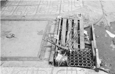
Cửa thu thoát nước kiểu cũ thường bị rác thải, lá rụng bít tắc. Ảnh: NNC
